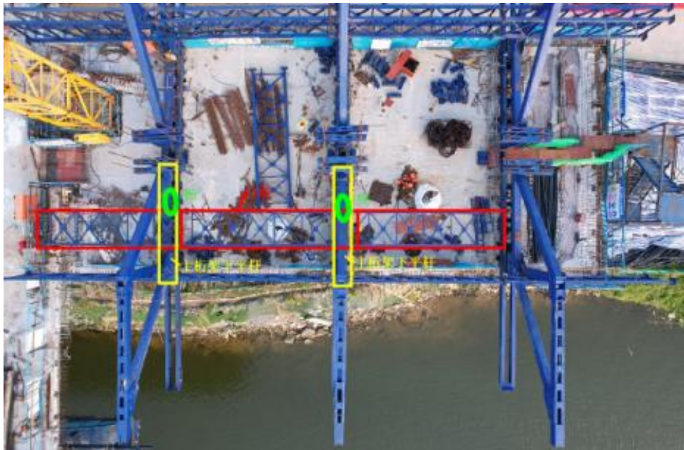
图3 事故现场情况照片（绿圈为事故发生时两名伤亡人员所在位置）
