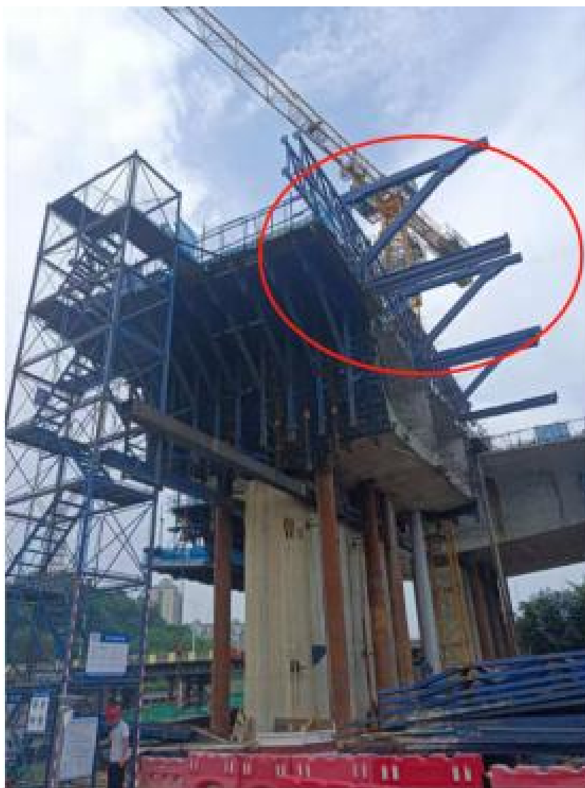
图 1 事故现场 7 号墩情况照片（红圈为事故发生位置）
