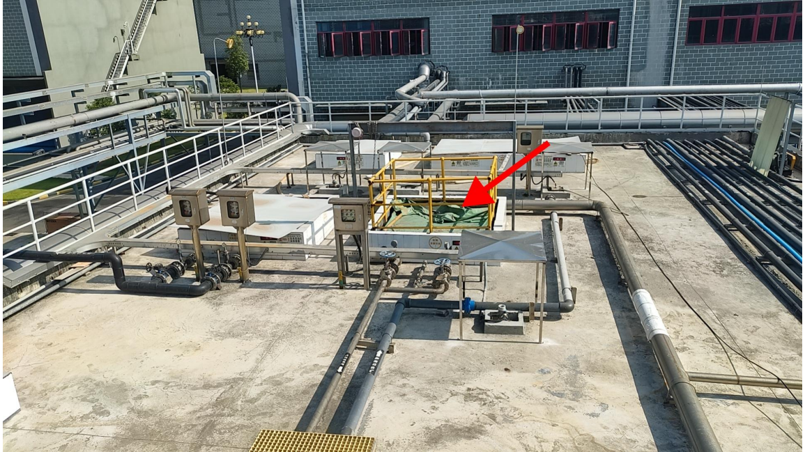
图一沼渣脱水上清液池入口
