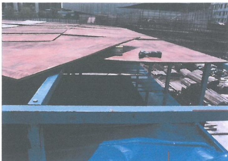
图 4 事故现场情况照片
