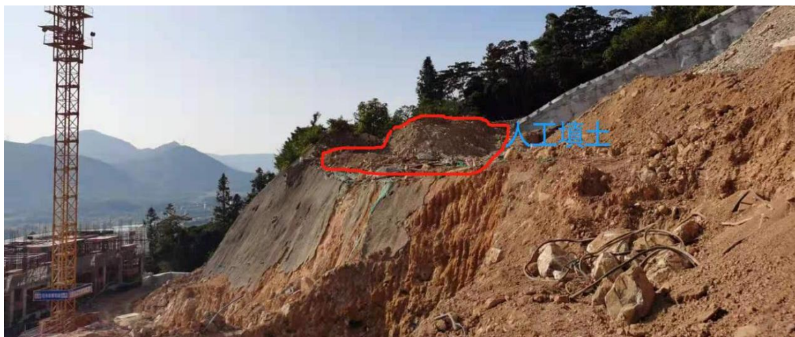
图 5 坍塌区域上方人工填土状况
